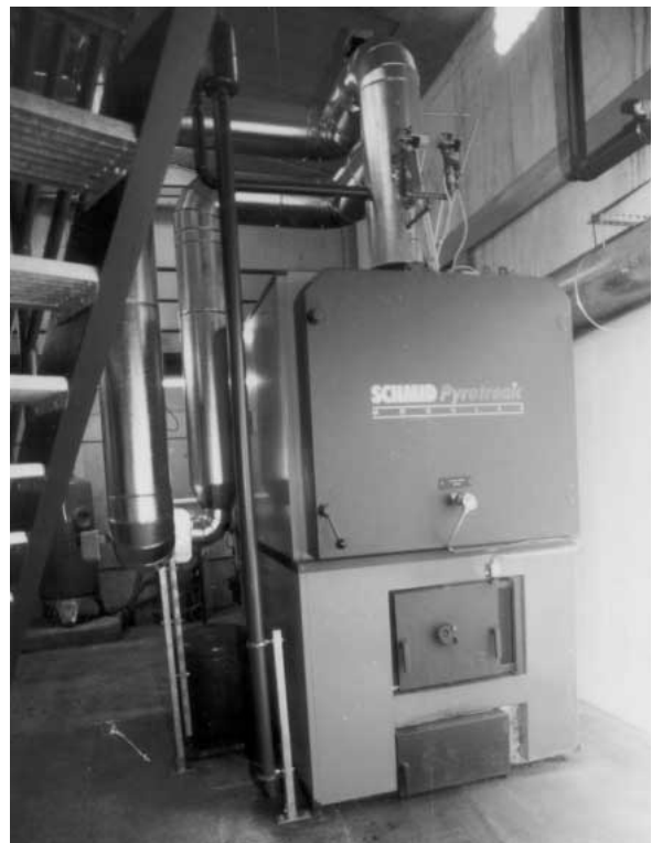
Das Holz-Hackschnitzel-Heizwerk im Baugebiet Reitsberger Gelände
